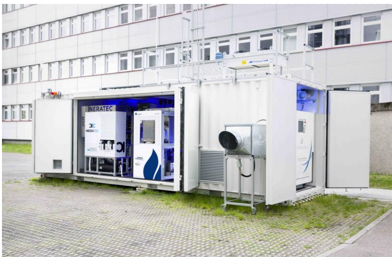
Weltweit erste integrierte Power-to-Liquid (PtL) Versuchsanlage zur Synthese von Kraftstoffen aus dem Kohlendioxid der Luft. (Foto: Patrick Langer, KIT)
