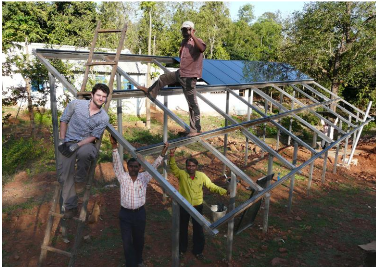
Die Photovoltaikanlage, hier noch im Aufbau, beliefert das Ausbildungszentrum im Dorf Gonasika mit Strom aus der Sonne. (Foto: EWB)
