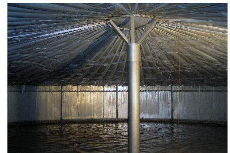
Innenansicht des Versuchsbehälters bei zum Teil abgelegter Gasmembran auf der Stützkonstruktion. (Foto: Rosemarie Wagner, KIT)
