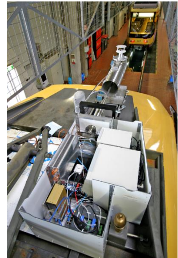
Messinstrumente auf dem Dach der AERO-TRAM (Foto: VBK)
