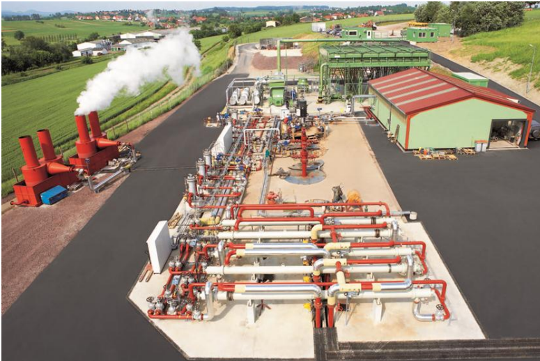
Tiefe Geothermie: das Kraftwerk in Soultz-sous-Forêts im Elsass (Bild: G.E.I.E.)
