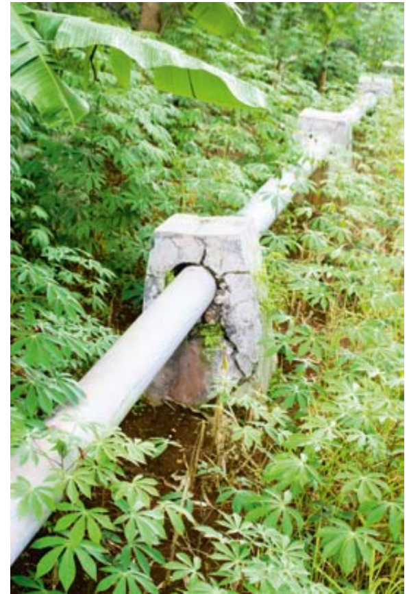
Marodes System: Viele Leitungen in der Gunung Kidul sind schadhaft.
