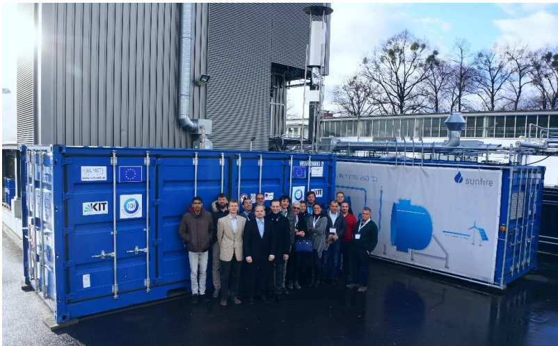
Die Demonstratoranlage des Projekts HELMETH verbindet Methanisierung (links) und Elektrolyse (rechts) mit einem Wirkungsgrad von 76 Prozent. (Bild: sunfire GmbH)
